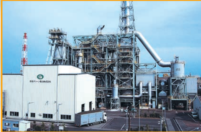
バイオマス発電プラント
