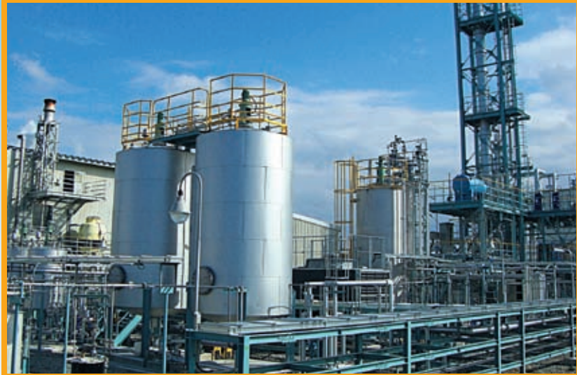
バイオエタノール製造プラント（でんぷん系）
