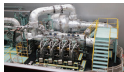
Actual SCR equipment
