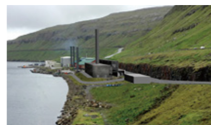
フェロー諸島向けディーゼル発電設備
