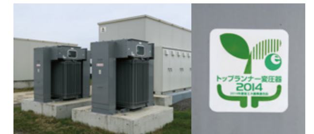
トップランナー規格品を採用した高圧変圧器
