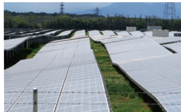
土地の雨水勾配をそのまま維持して設置された太陽光パネル
