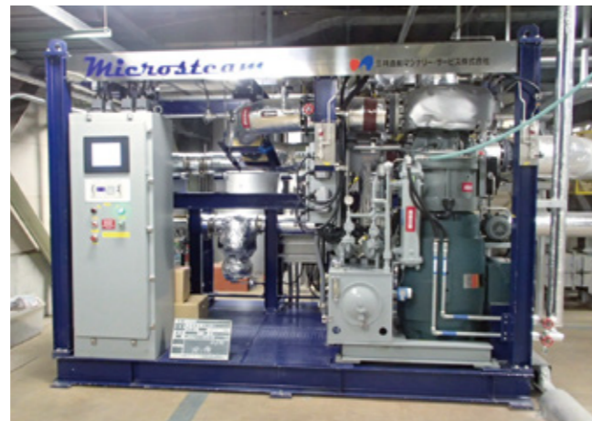
唐津市清掃センター内の小規模蒸気発電設備
