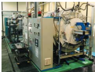
PCB分離回収・分解処理装置
