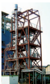
バイオマスガス化発電パイロットプラント
