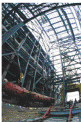
中国・山東省向け300MW発電プラント (建設中) (MITSUI BABCOCK ENERGY LIMITED)
