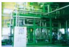
廃発泡スチロールリサイクルプラント
