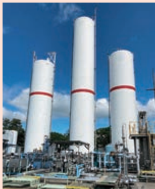
LNG燃料供給設備
