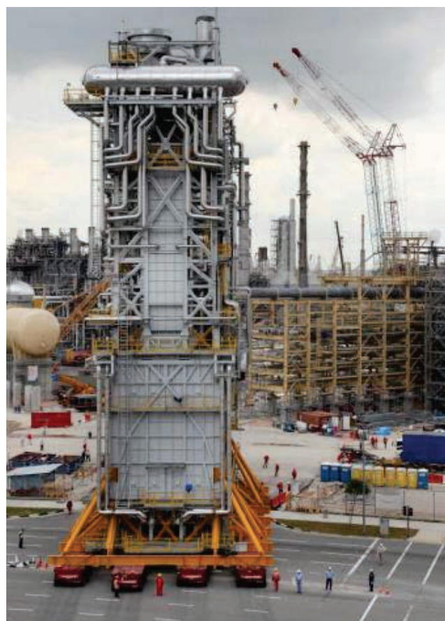
写真7 エチレン分解炉のモジュール
