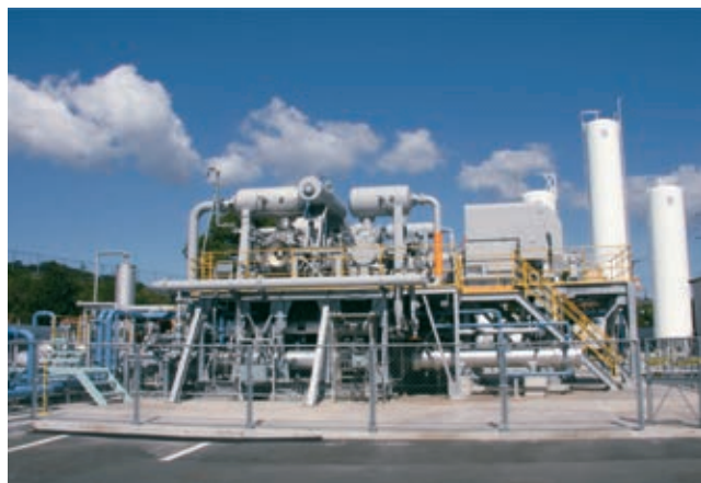
写真3 SFSS用高圧ガス圧縮機 (工場設備機)
