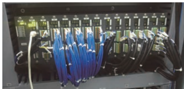
写真 2 油圧制御装置 Hydraulic Controller
