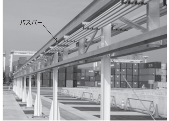
写真2 ヤード全域に配置したバスバー
