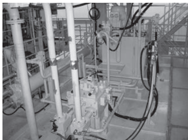
写真7 バルブブロック(手前)と油圧ユニット(奥) Valve Block and Power Unit
