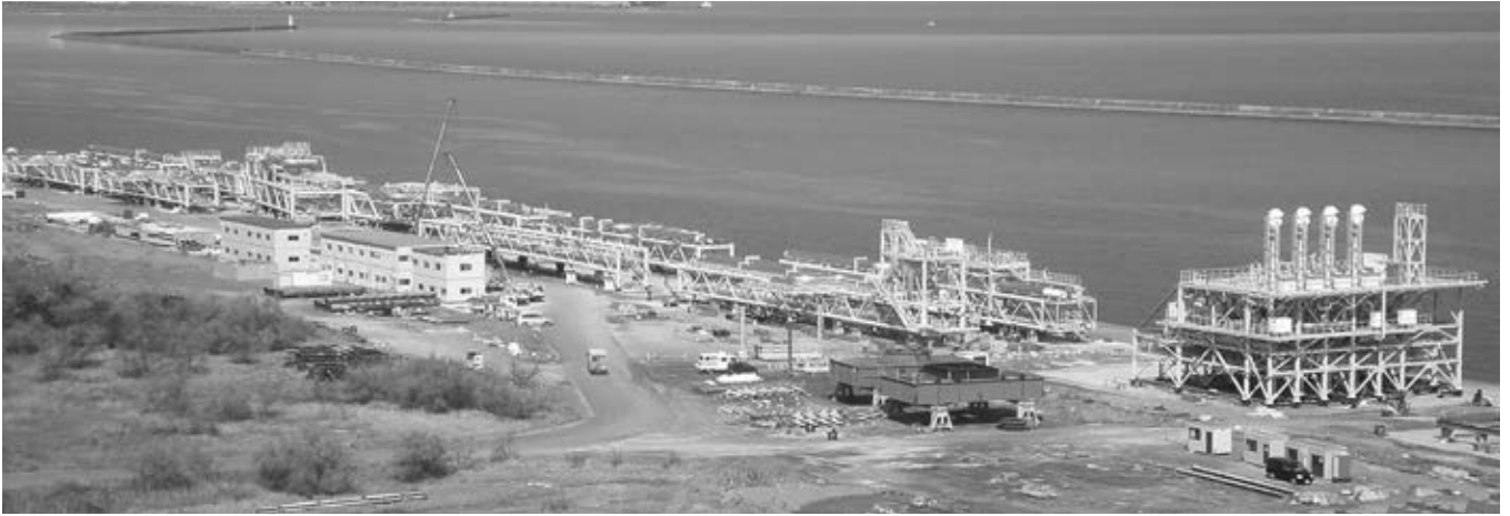
写真1 モジュール群全景
