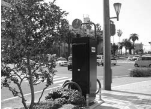
写真1 新型非常用電源装置設置状況
