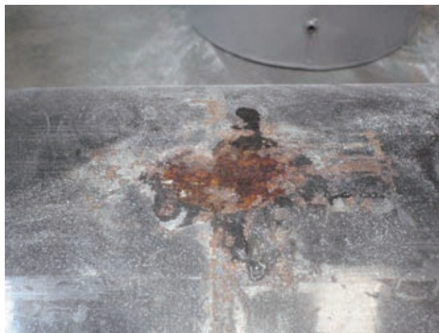
写真2 モックアップに導入した腐食部の外観 Appearance of the Corrosion on the Mock-up
