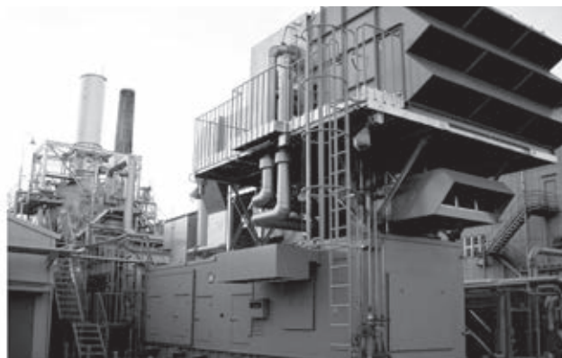
写真2 MSC70 コージェネレーション設備全景
