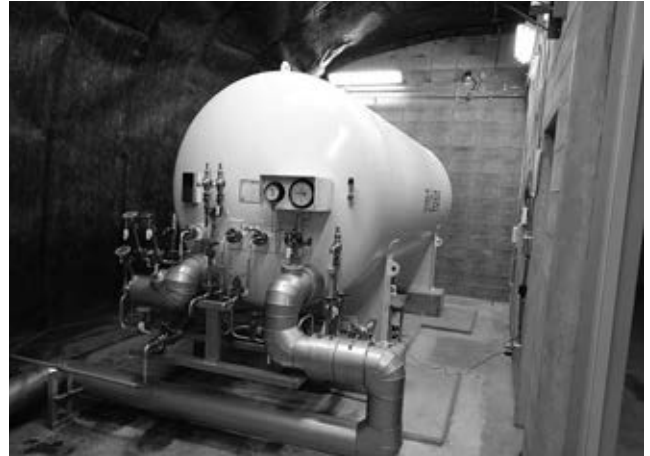
写真2 貯槽本体(二重殻タンク)
