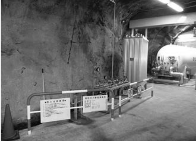
写真1 液体窒素貯蔵設備
