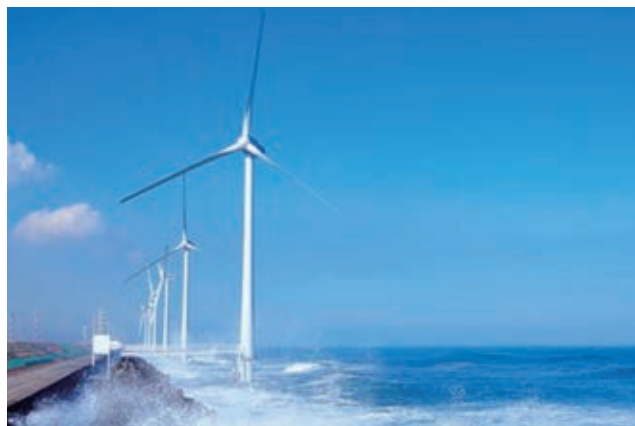
写真7 神栖風力発電設備
