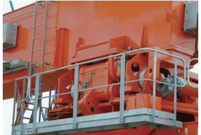
写真9 クレーン免震装置
