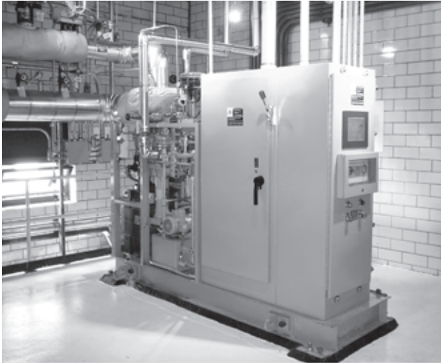
写真1 米国エナージェント社の Microsteam ® 設置例 (New York Con Edison ビル)
