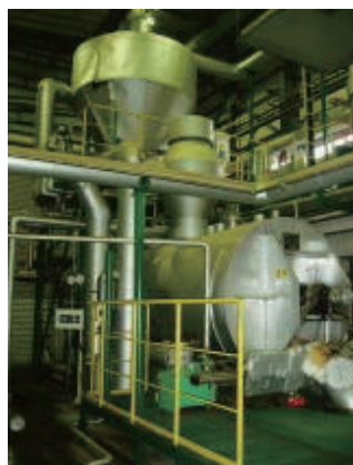
写真3 油温減圧式乾燥装置(クッカー) Pressure Reduction Type Drying Machine
