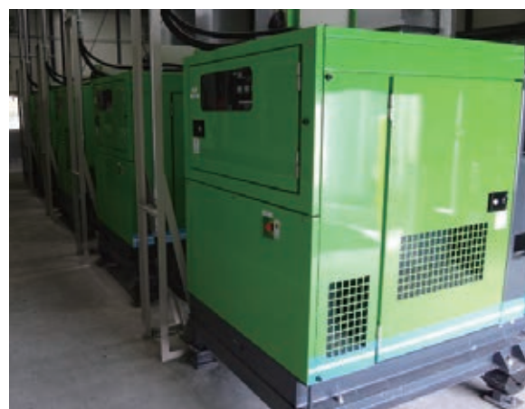
写真5 ガス発電機 Gas fired Generator
