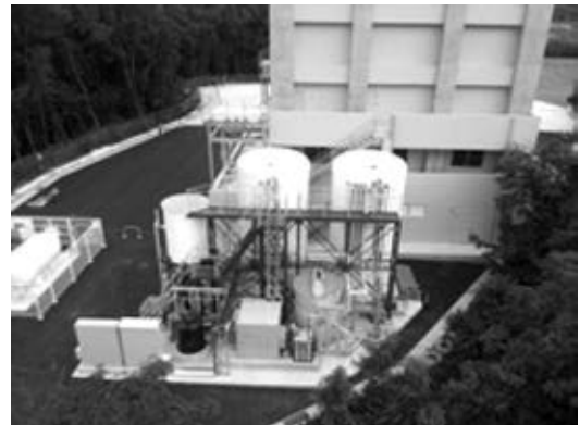
写真3 LPGバルクタンク設備(左)及び泡消火排水処理設備(中央)
