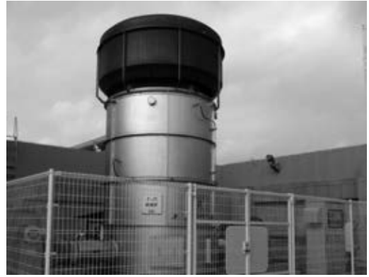
写真2 排煙処理設備
